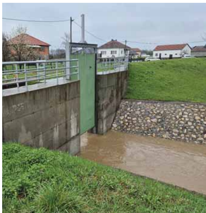
Ustava na kanalu "Bosna-Bukovica" u naselju Gornja Dubica
