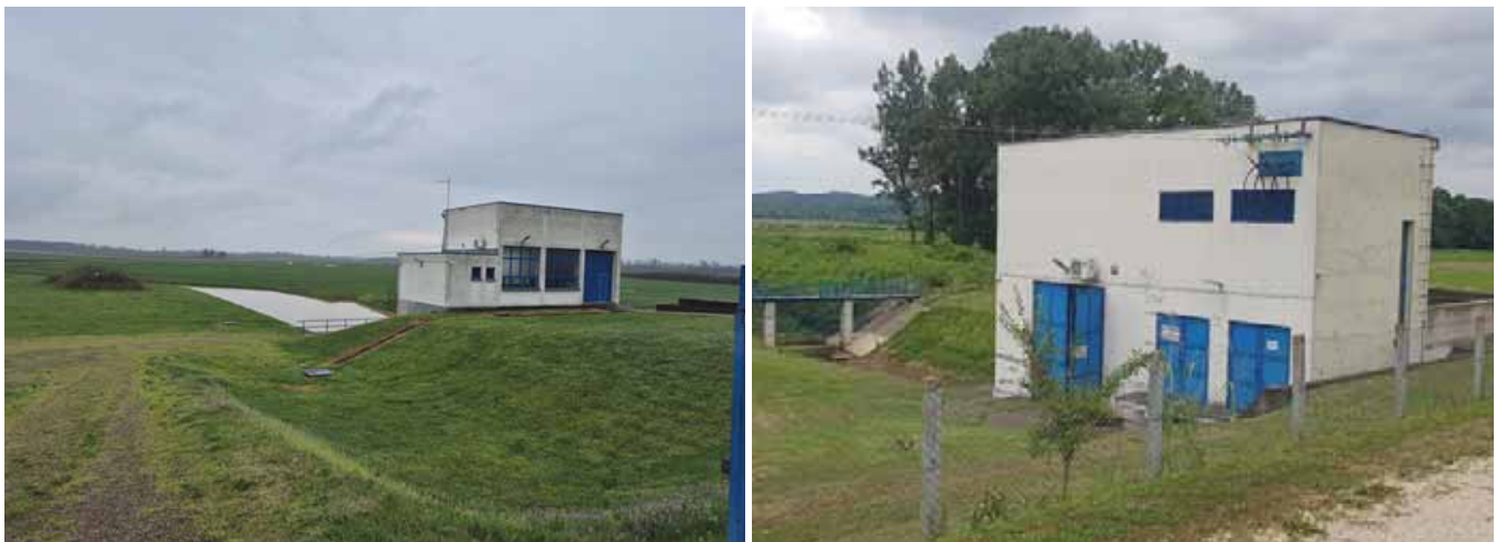
Objekti za ispumpavanje unutrašnjih voda u Savu kada je gravitacijski otok onemogućen- CS Zorice II (lijevo) CS Svilaj (desno)
